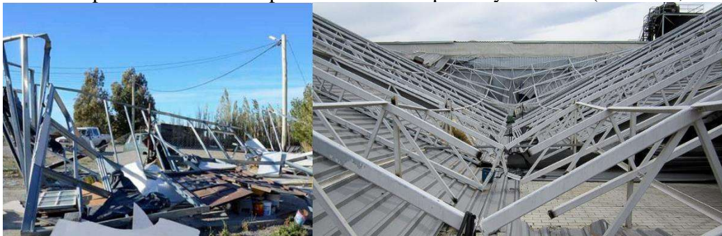
Figura 4. Colapso de estructuras, a la izquierda de una casa-habitación (Buenos Aires, Argentina, 2013); a la derecha, de una nave industrial (México).
