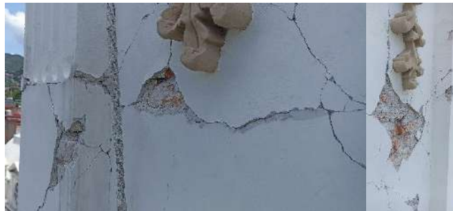
Figura 6. Grietas torre norte, lado norte. Fuente propia.
