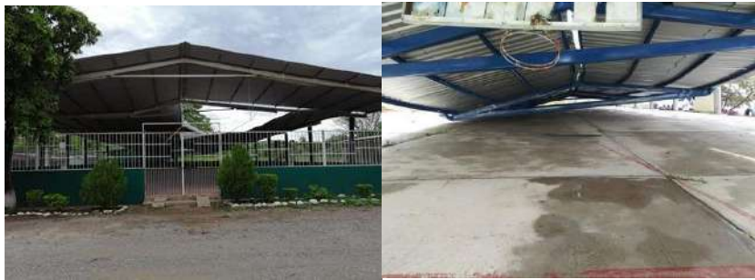
Figura 3. Colapso de estructuras tipo techumbres en plazas y escuelas (Guerrero, México).
