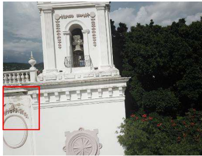
Figura 2. Daños de acabado de fachada principal (superior derecha). Fuente propia.
