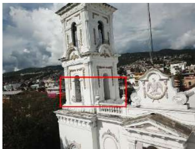
Figura 4. Daños de cortante en toda la base de la torre – campanario norte. Fuente propia.
